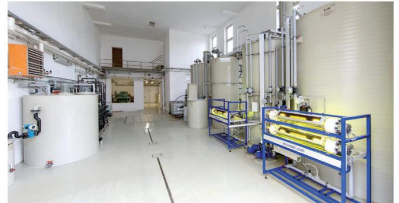
Abb. 6: Abwasseranlage, im Vordergrund die beiden UV-Oxidationsreaktoren
