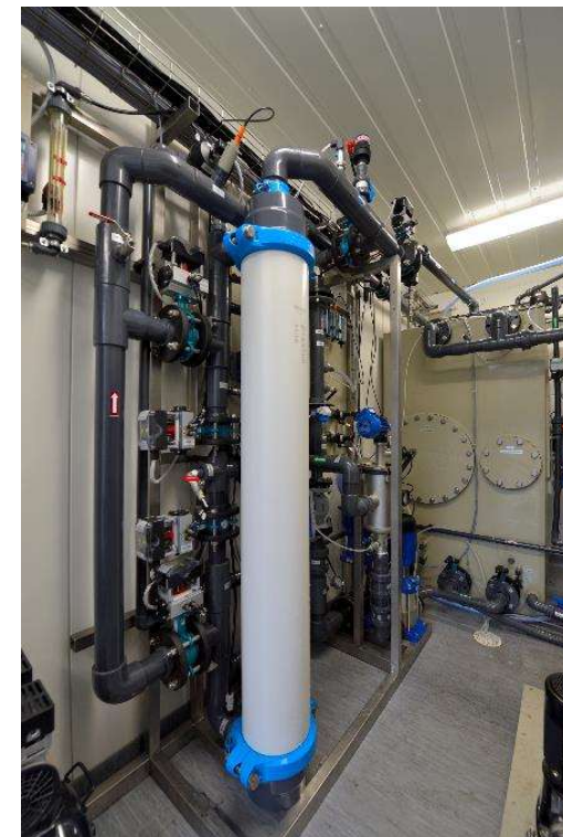
Erweiterte Aufbereitung Flockung, UF
