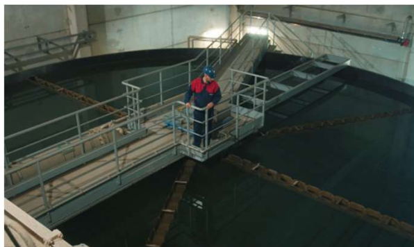
Zulauf für Prozesswasser
