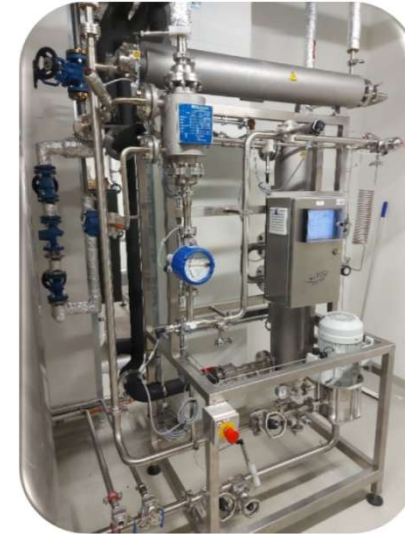
WFI Ringleitungsskid mit Pumpe, Ozonerzeugung, Wärmeübertragern und On-Line-Messungen
