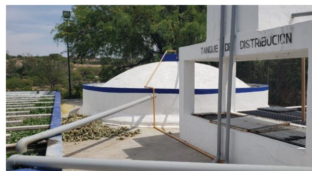
*Abwasserbehandlungsanlage in der Gemeinde Calvillo im Bundesstaat Aguascalientes
